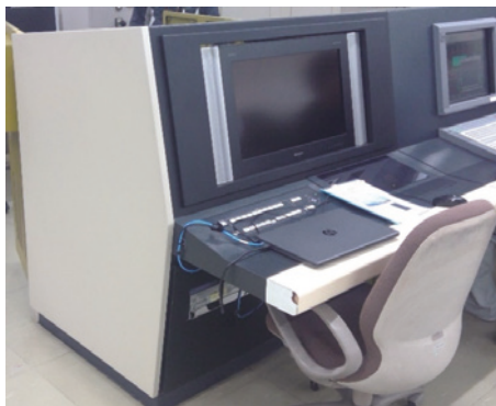
写真 3.1.2.10 制御室 ITV 操作卓更新前
