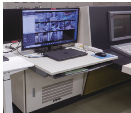
写真 3.1.2.11 制御室 ITV 操作卓更新後
