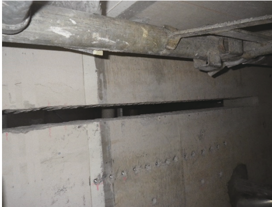
写真 2.1.6 耐震スリット
