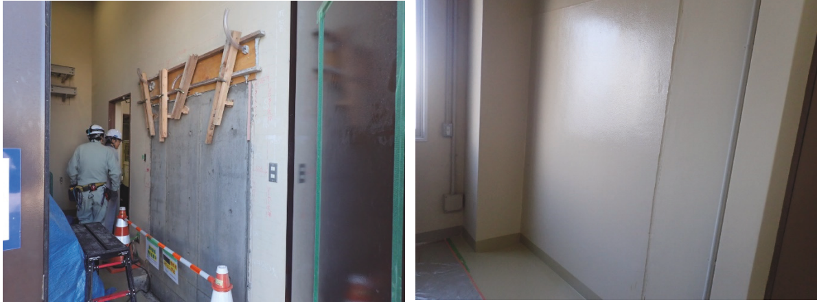
写真 2.1.28 冷却塔ポンプ室開口閉塞
